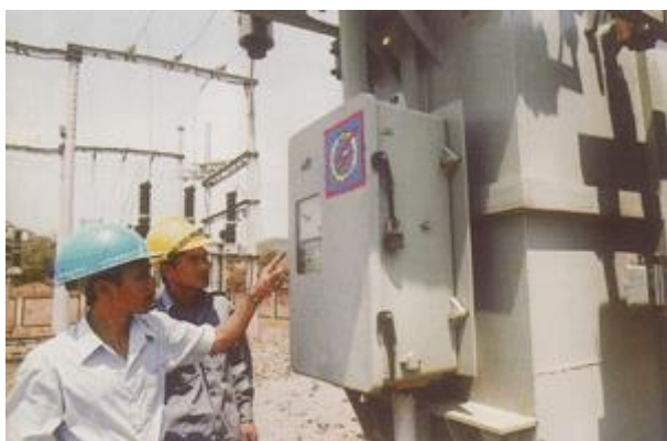
Công nhân Lào – Việt Nam trao đổi kinh nghiệm vận hành tại trạm biến áp Đen Xá vắn (Lào), năm 2001
